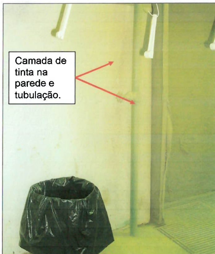
Figura 8 - Fotografia da parede ao lado da entrada da cabine de pintura, apresentando camada de tinta proveniente da cabine.
